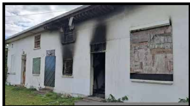
16 juin 2024, veille de la rentrée scolaire. Incendie de l'école primaire dans le quartier de la Vallée du Tir (Nouméa)
